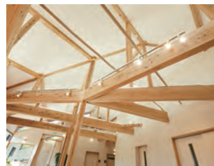
無垢材を使用している「梁（はり）」
